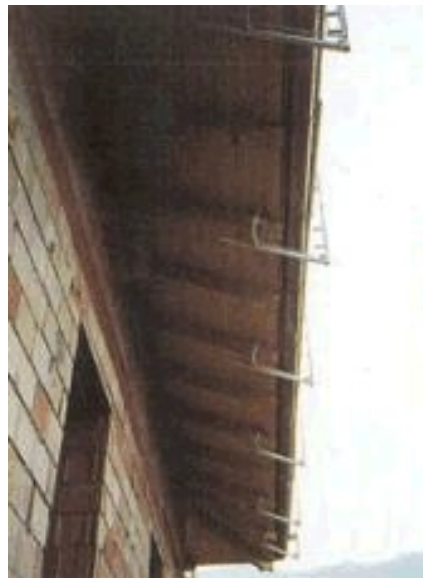
Sistema di protezione dei bordi
